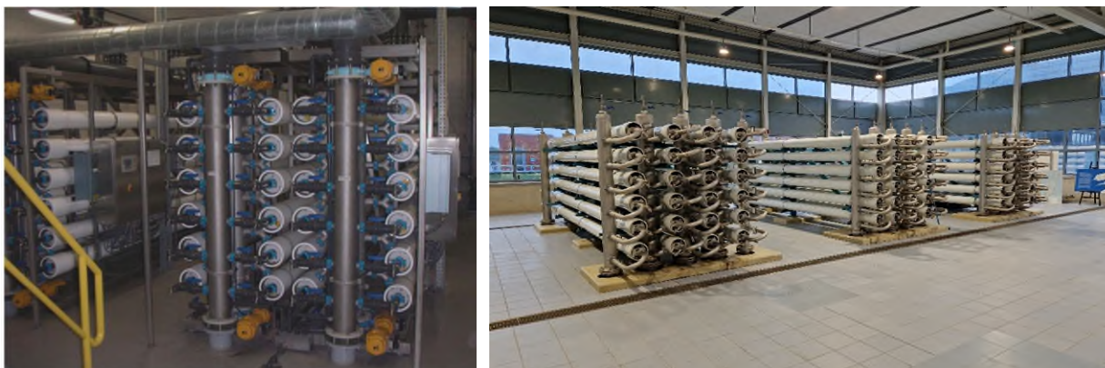
Figuur 3-1 Voorbeeld UF installaties met meerdere stacks: links drinkwaterproductielocatie Ouddorp (Evides Waterbedrijf) [12] en rechts drinkwaterproductielocatie Heemskerk (PWN).
